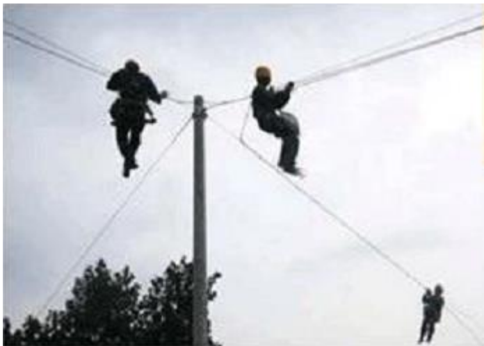
图一：经测试杆路设备无带电情况下进行架空作业，正常情况下，在雷雨或将要雷雨时，禁止在杆上或高空工作
