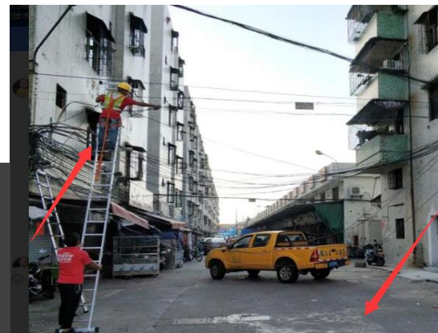
图四：作业现场有坠落可能的物件，应一律先行撤除或加以固定；围蔽作业区，必要时设专人值守，非作业人员不得进入作业区域
